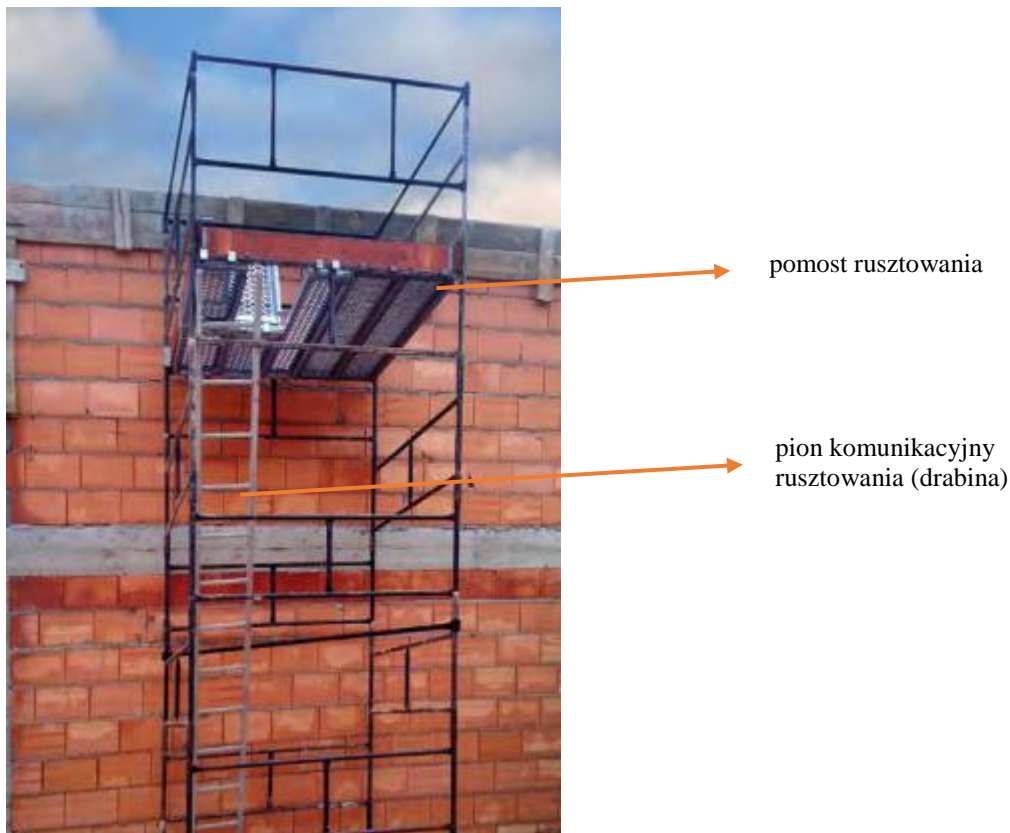
Rys. 2. Rusztowanie ochronne zabezpieczające pracowników przed upadkiem z wysokości [4].
